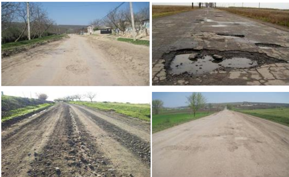
Figura 2-10: Degradări ale drumurilor locale
