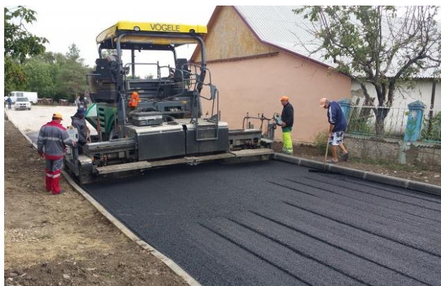
Lucrări în cadrul proiectului „Construcția drumului intercomunitar L509 Feștelița-Marianca de Jos-Ștefan Vodă și asigurarea conexiunii cu drumul național R 30 Chișinău-Căușeni - frontiera cu Ucraina”
