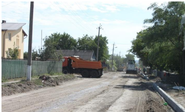
Lucrări în cadrul proiectului „Dezvoltarea infrastructurii de afaceri prin conectarea localităților și a drumurilor locale de pe coridorul R20 – RD Sud, R34 – Sîrma – Tomai – Sărăteni – Hîrtop la rețeaua de drumuri naționale R3”
