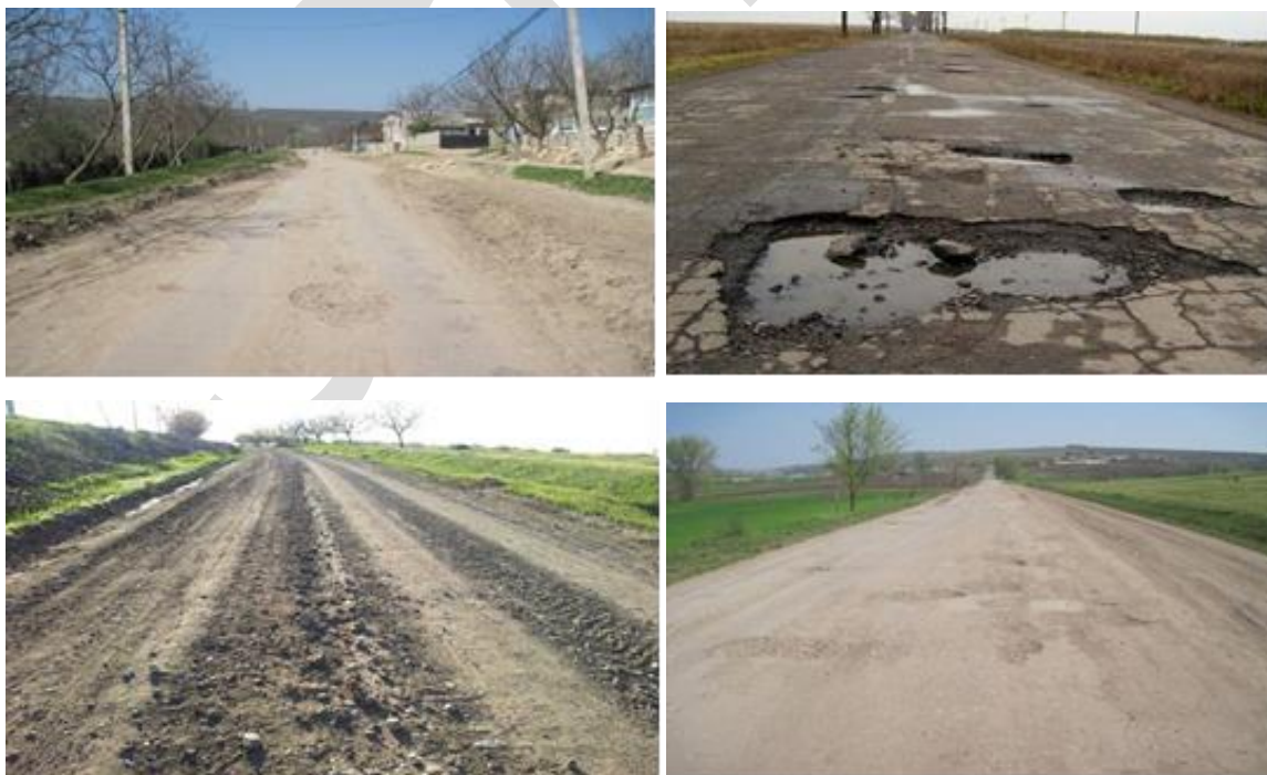
Figura 2-10: Degradări ale drumurilor locale
